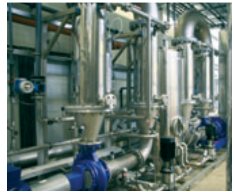
Ultrafiltrations-Teilanlage mit Edelstahl-Membranmodulen
